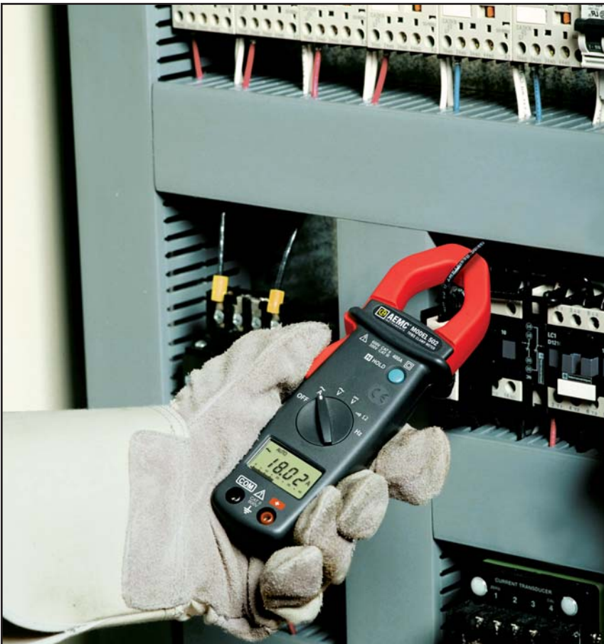
Monitoreo de la corriente de fase en un tablero de potencia con la pinza Modelo 502.
